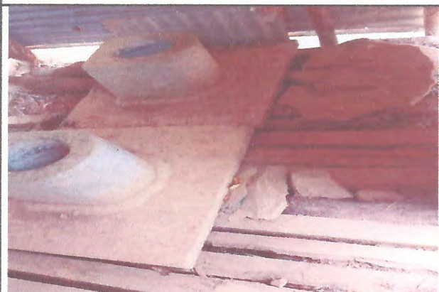
Foto 4: estado actual del baño
